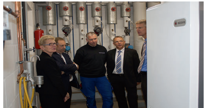
Inbetriebnahme der Brennstoffzelle zur Senkung der Energiekosten im Fallstein-Gymnasium
